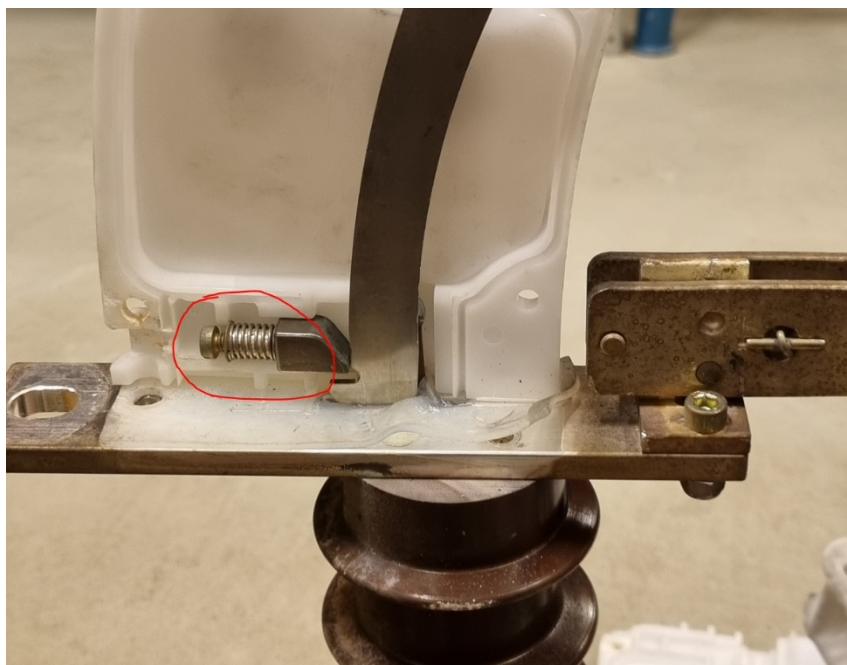
Bild 1. Justerskraven inne i släckkammaren och den klack som låser ljusbågskniven. Ljusbågskniven ska släppa från låsklacken när frånskiljaren öppnats ca 10 cm.
